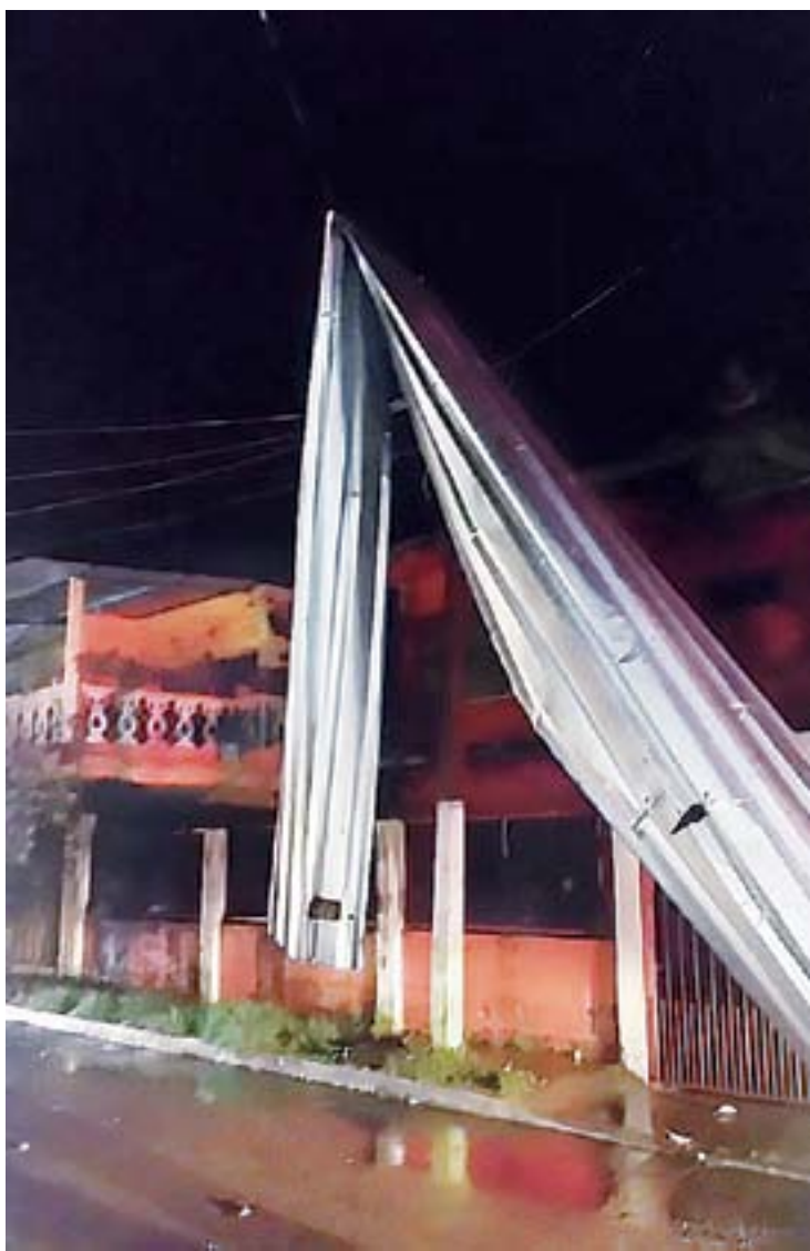
PROTECCIÓN CIVIL de Las Choapas activó un operativo para atender múltiples reportes de láminas desprendidas.
