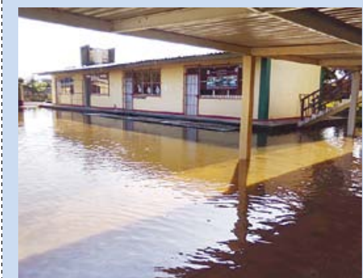
HASTA EL MOMENTO suman 148 escuelas federales las que se dañaron durante las pasadas inundaciones.
