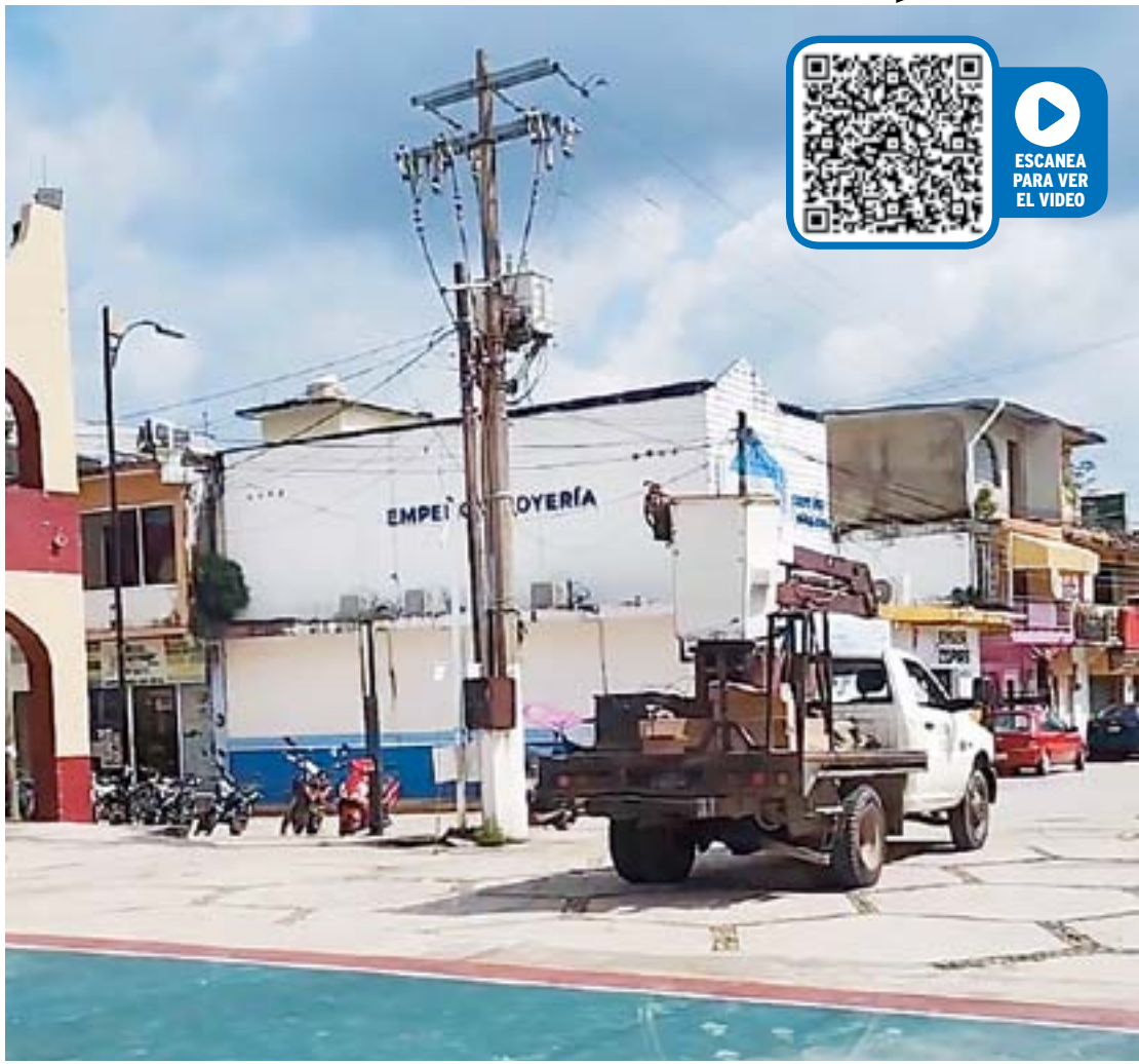
ESTE MARTES EL PALACIO MUNICIPAL de Las Choapas se quedó sin energía, tras el corte realizada por la CFE por falta de pago.
