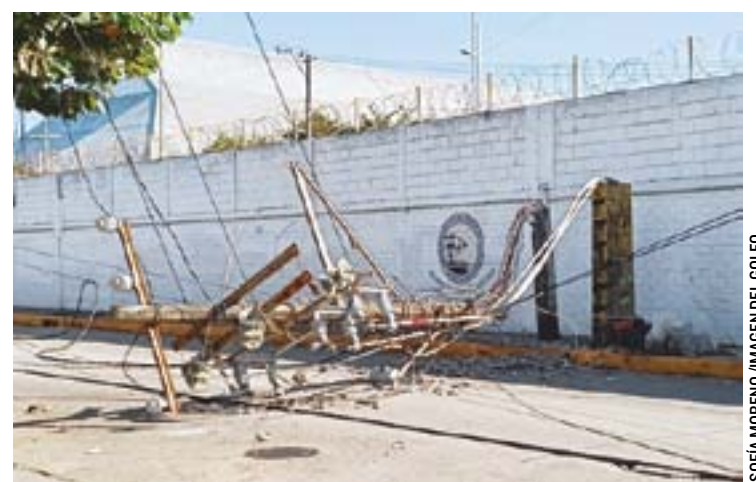
EL POSTE y sus pésimas condiciones fueron reportados hace un año a la Comisión Federal de Electricidad (CFE).
