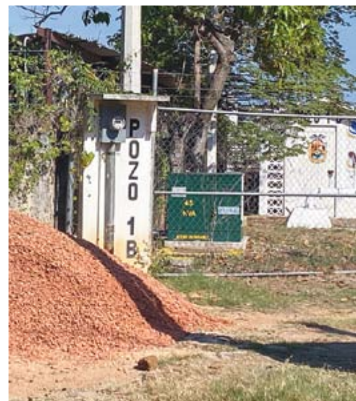
EL POZO QUE COSTÓ MÁS de dos millones de pesos y resultó inservible.
